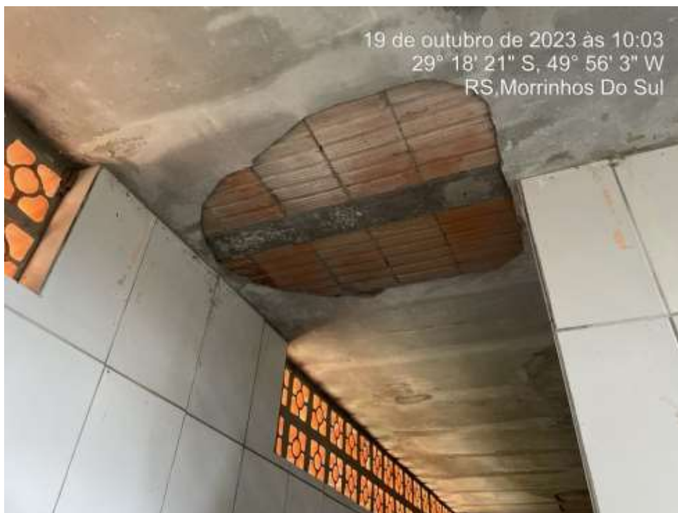
Figura 25: Infiltração na laje e descolamento do reboco.
