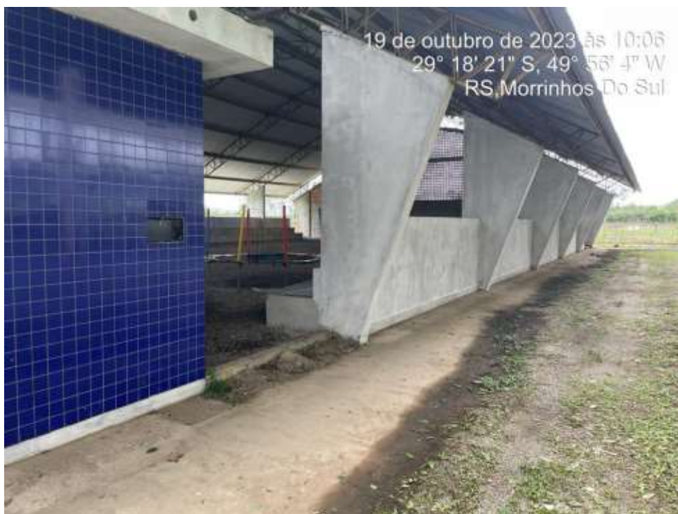
Figura 36: Drenagem pluvial faltante.
