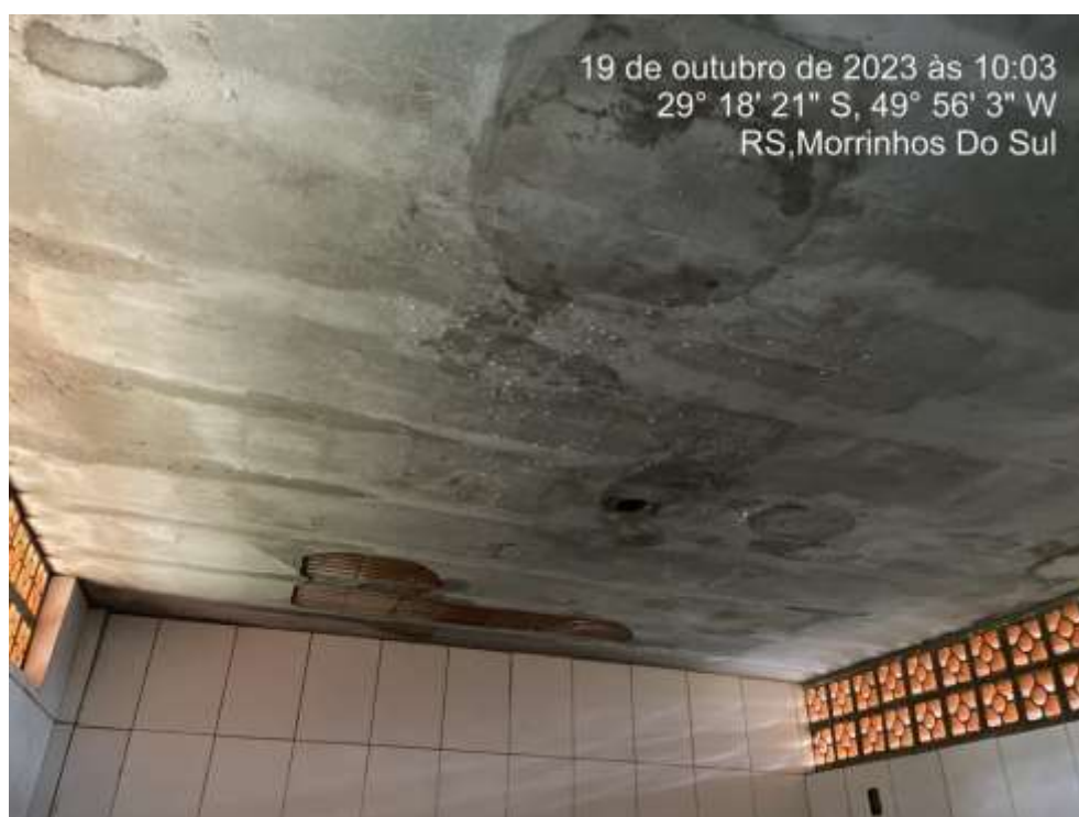
Figura 24: Infiltração na laje e descolamento do reboco.
