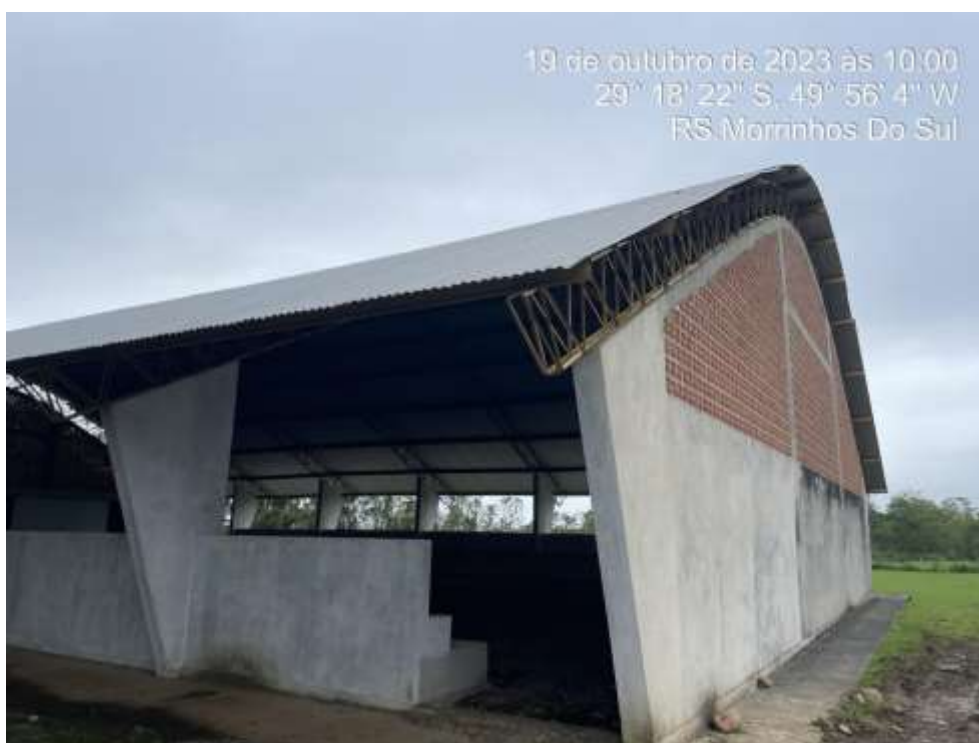
Figura 40: O sistema de proteção contra descargas atmosféricas não foi executado.
