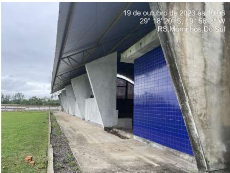
Figura 35: Drenagem pluvial faltante.
