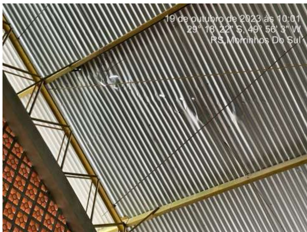
Figura 16: Telhado danificado pelo ciclone bomba.
