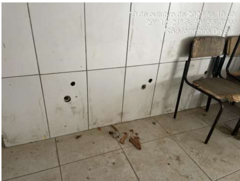
Figura 44: Serviços diversos não foi executado.
