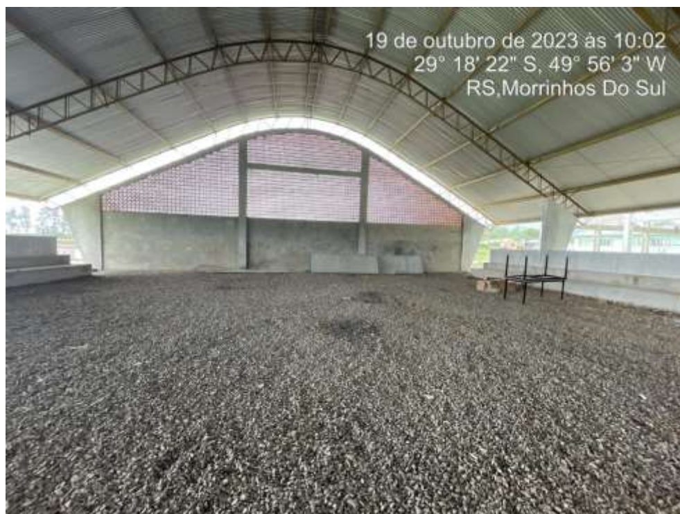
Figura 41: Serviços diversos não foi executado.
