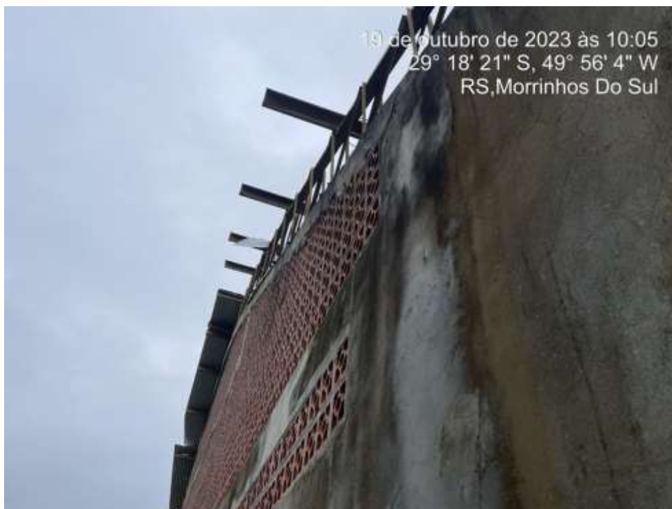
Figura 17: Telhado danificado pelo ciclone bomba.
