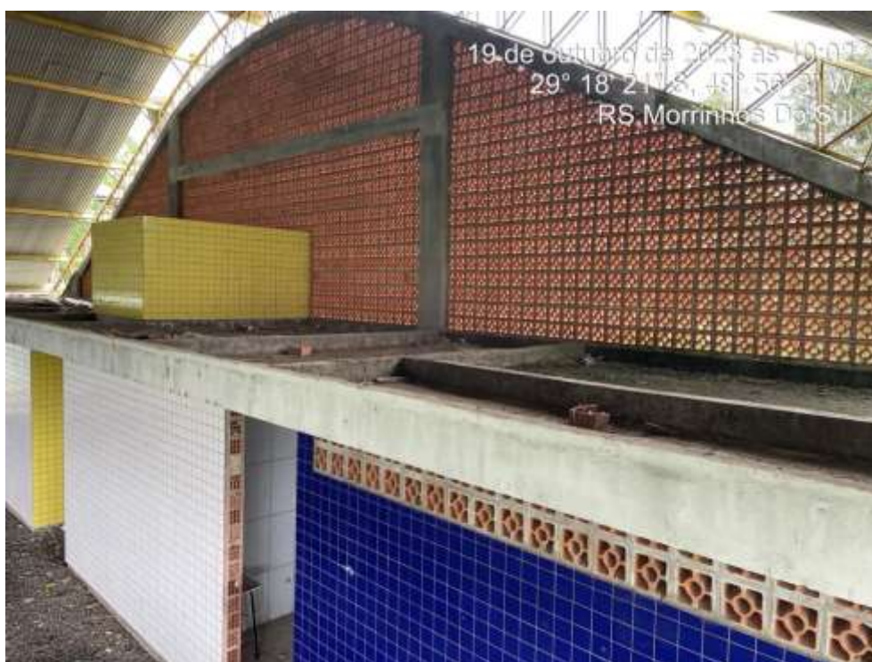
Figura 8: Laje de cobertura dos banheiros e vestiários sem impermeabilização.
