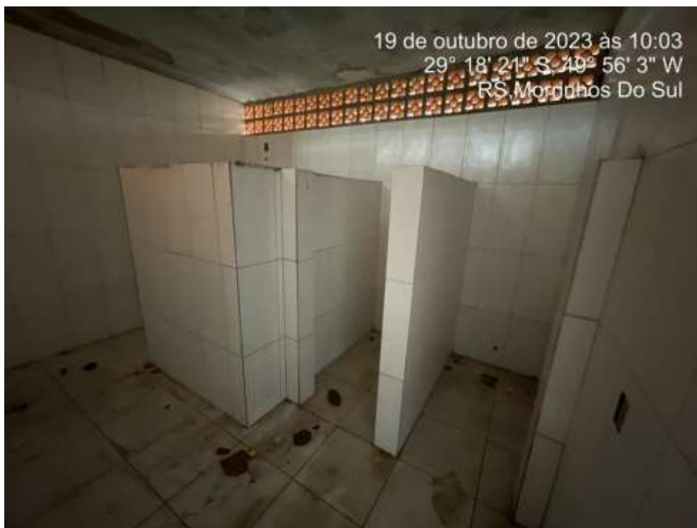
Figura 43: Serviços diversos não foi executado.
