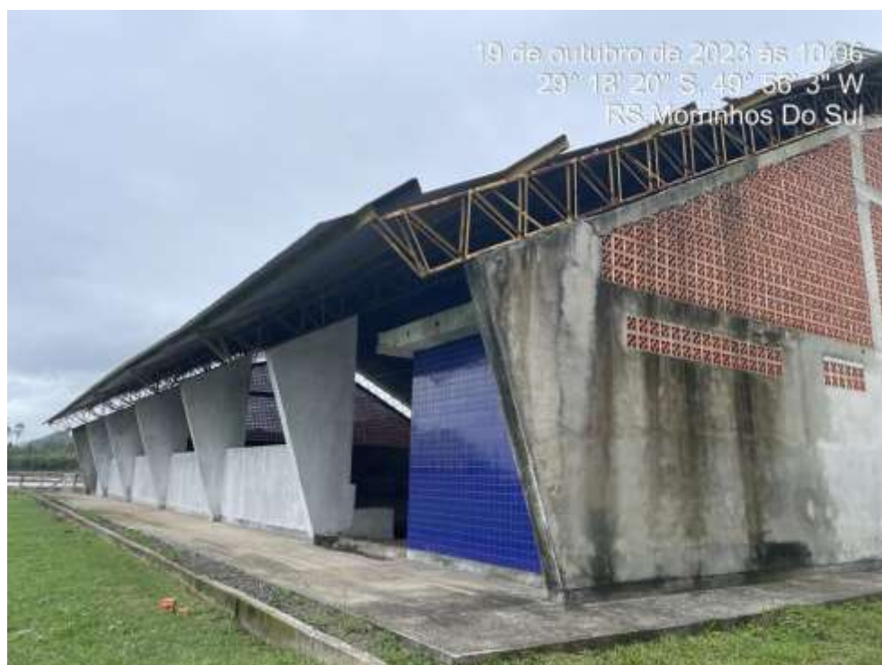
Figura 42: Serviços diversos não foi executado.
