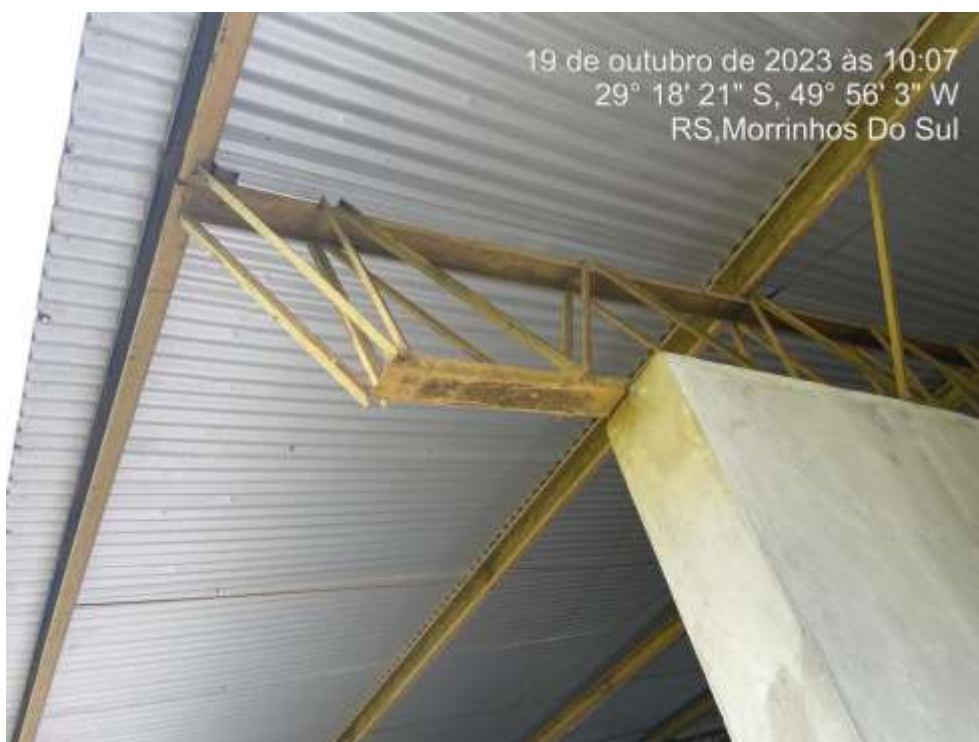
Figura 20: Telhado danificado pelo ciclone bomba.
