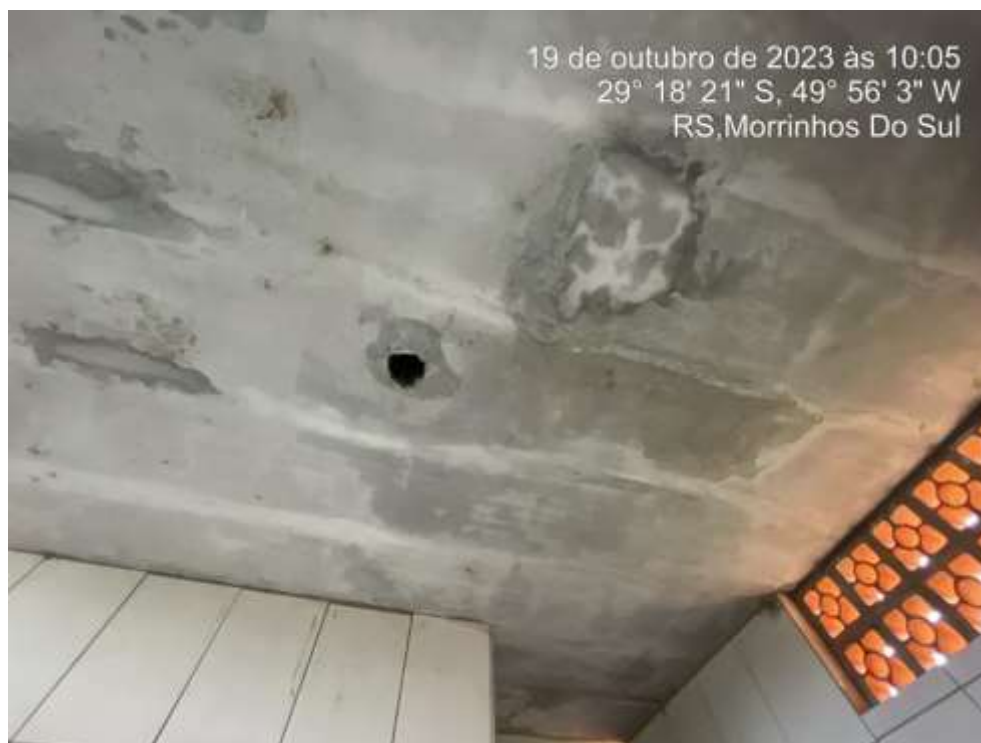
Figura 23: Infiltração na laje de cobertura dos banheiros e vestiários.
