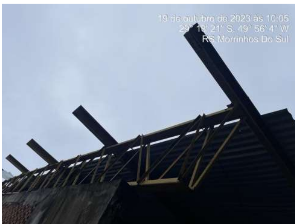
Figura 18: Telhado danificado pelo ciclone bomba.
