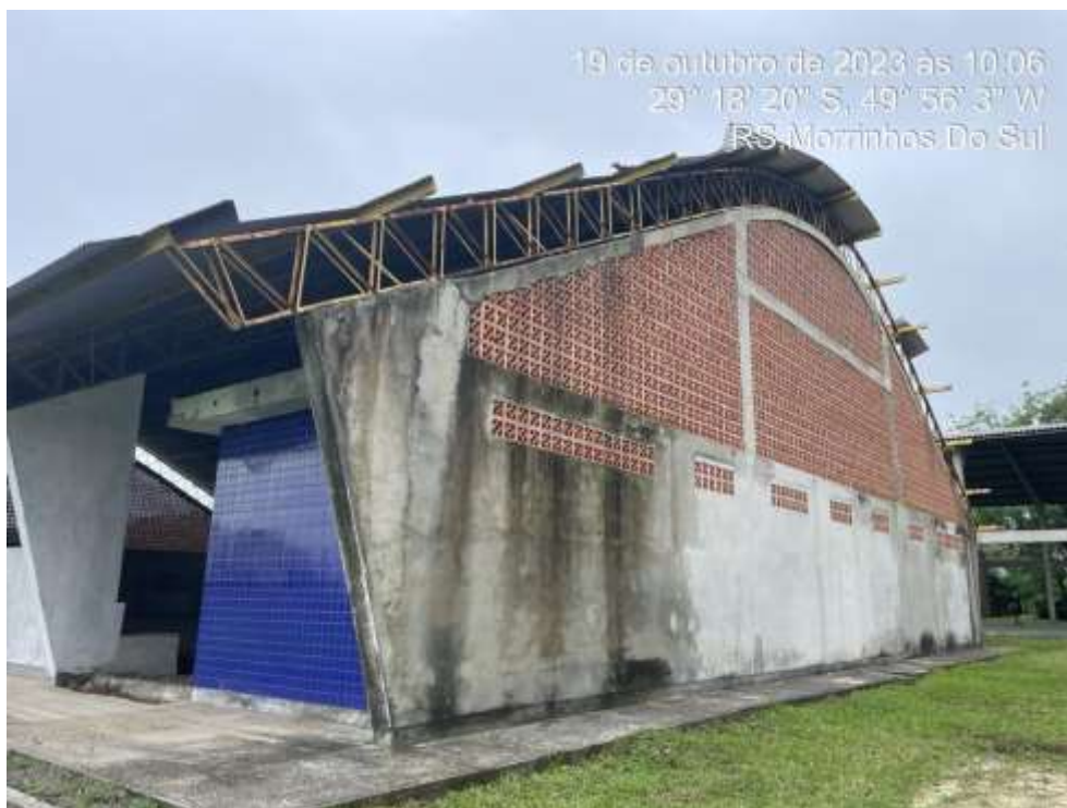
Figura 19: Telhado danificado pelo ciclone bomba.
